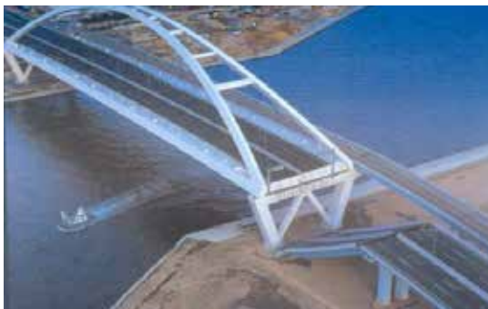
شکل ۵: خرابی پل Nishinomiya در اثر پدیده گسترش جانبی در زلزله کوبه [۶]
