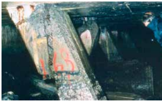
شکل ۴: خرابی شمع اسکله بندر Okland در زلزله لوماپریتا [۶]
